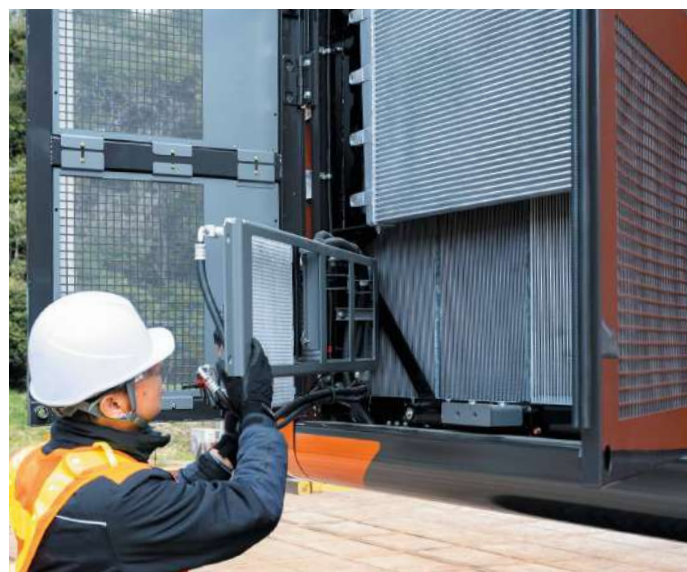
Condensador de aire acondicionado de fácil acceso
